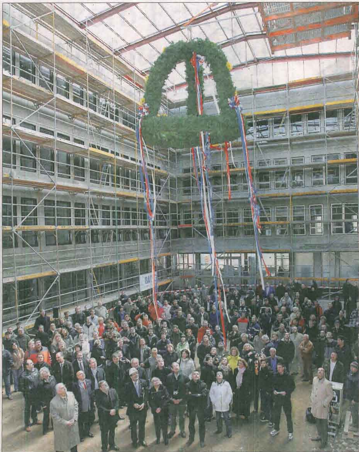
Hunderte Gäste waren zum Richtfest des neuen Uni-Rechenzentrums in der Südstadt gekommen.
